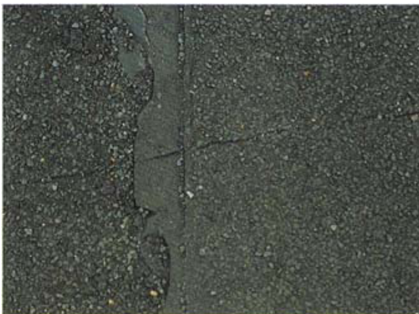
Fig. 2. Revner i tagpap foranlediget af isspændinger.
